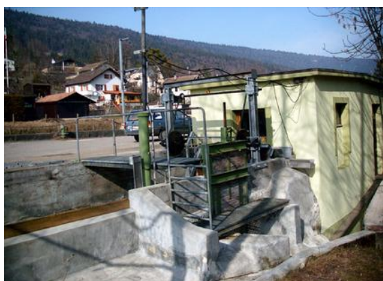
La pico-centrale de Cormoret, dans le Jura, a été remise en service (Photo: Revita)
