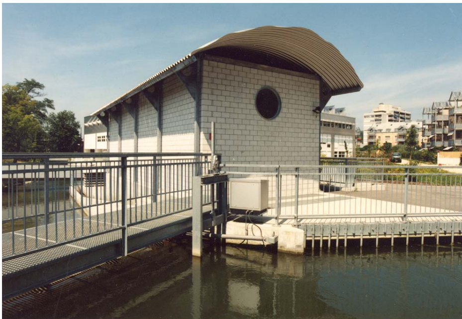
Ultra-Niederdruck-Kraftwerk Mülibach in Burgdorf, 70 kW im "Gkett" des Emmenkanals
