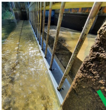
Figure 12 Photo de l'écran de protection mis en place devant les grilles grossières. Source : EnEn 2023.
