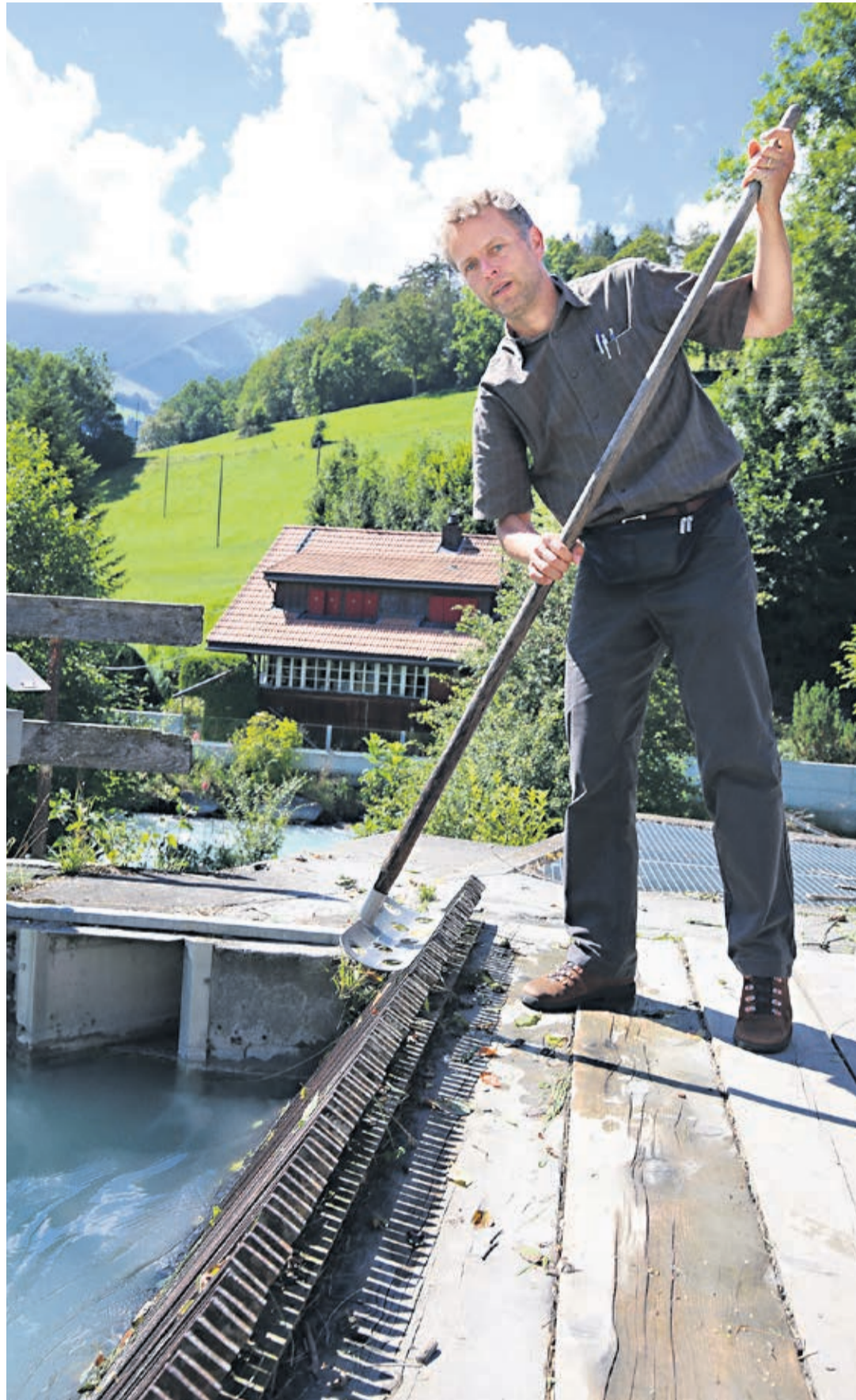
NOCH BEFREIT SAMUEL MOSER SEIN KLEINWASSERKRAFTWERK MANUELL VON LAUB. NACH DER MODERNISIERUNG ÜBERNIMMT DAS EIN MASCHINELLER RECHEN.
